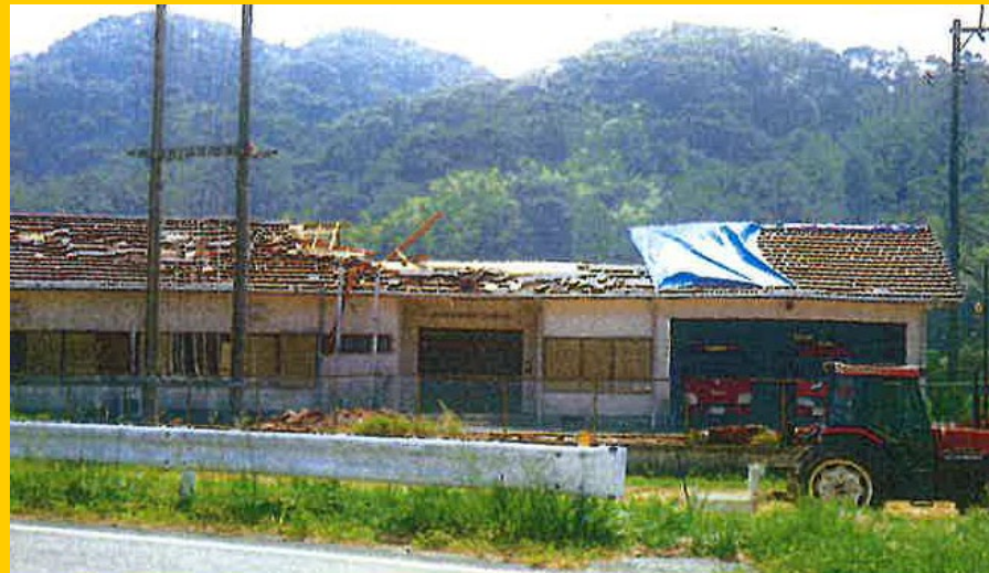
消防第二分団詰所 屋根破損
