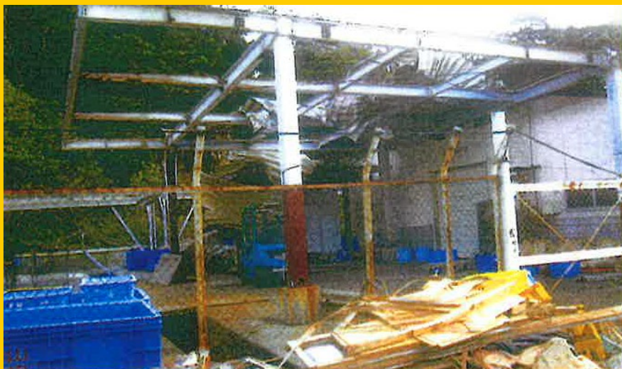
畜産施設 屋根・外壁破損
