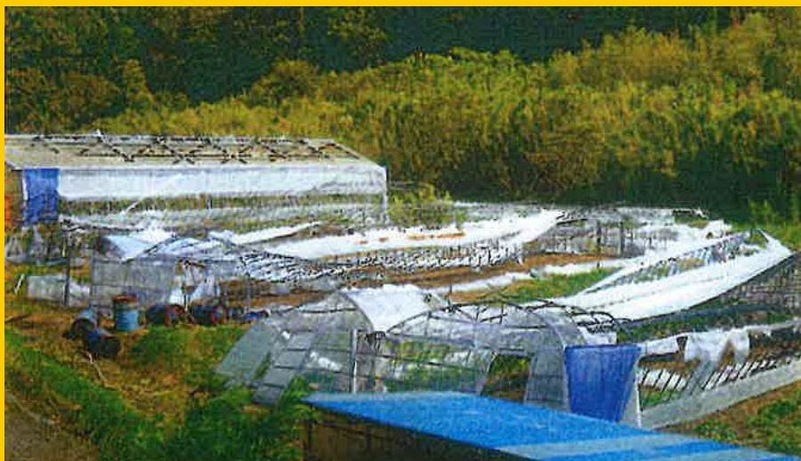
第六地区 ビニールハウス倒壊
