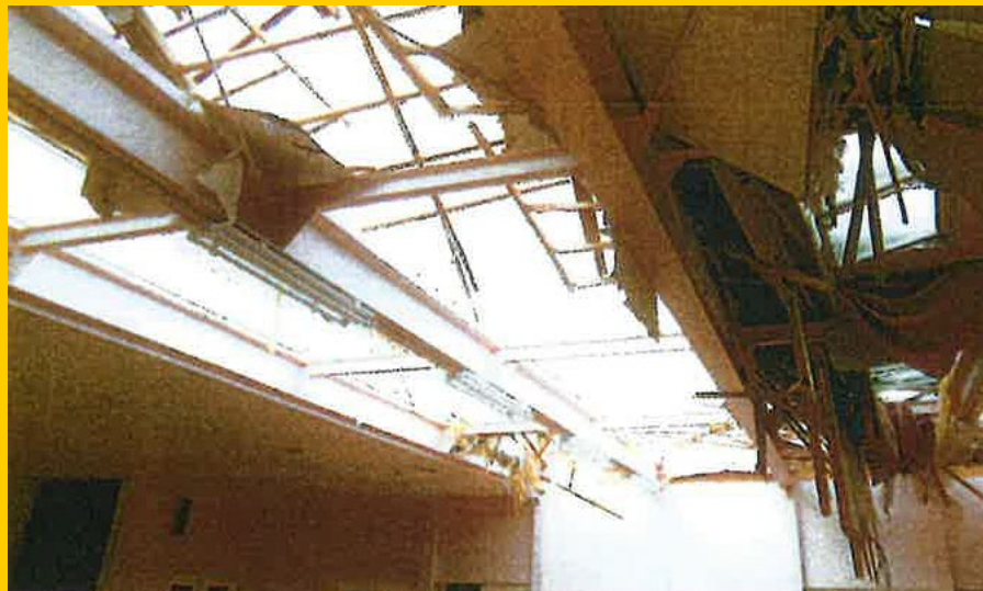
旧幼稚園 遊戯室屋根破損
