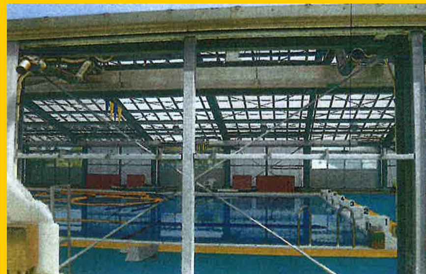
B&G海洋センター プール外壁・天井破損
