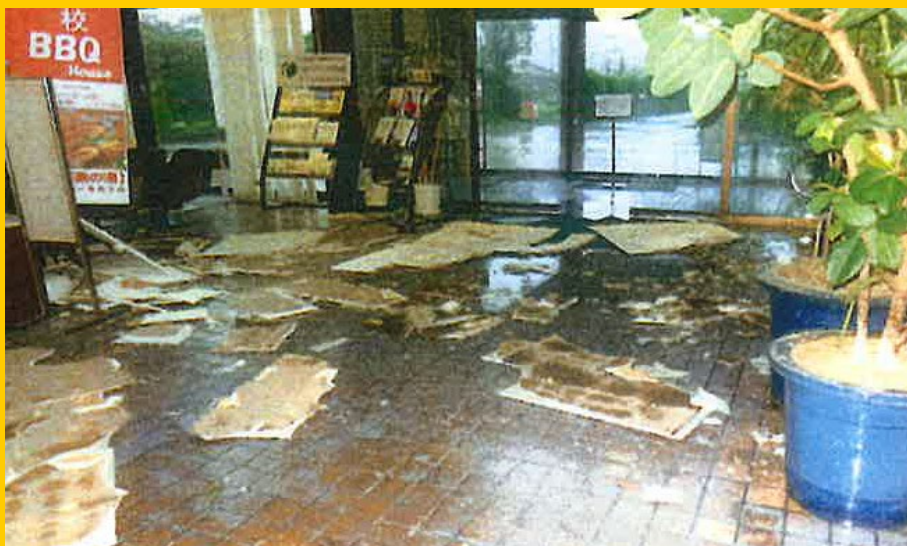
役場本庁舎 正面ロビー天井剥落
