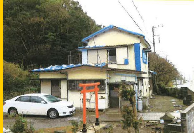
民家の屋根瓦が破損
