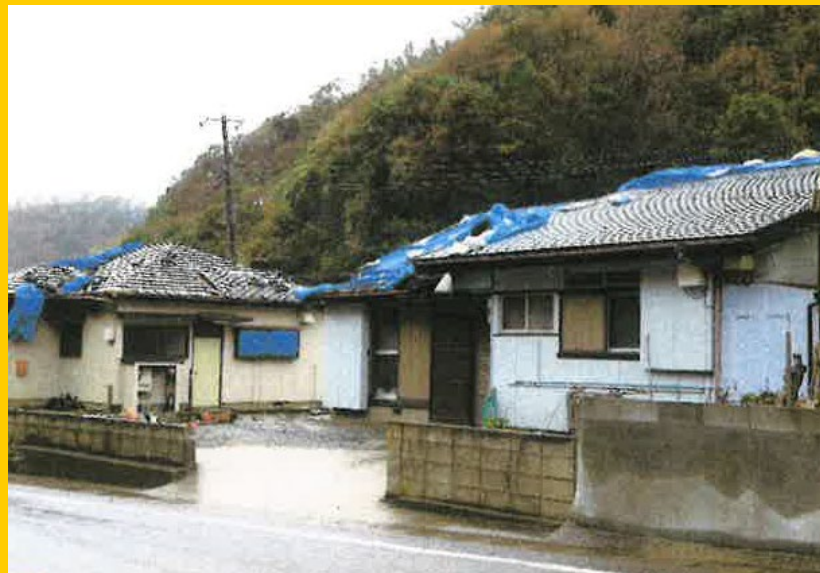
民家の屋根瓦が破損(海側が妻側の建物は棟や破風が被害を受けている)
