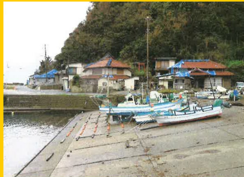
漁港付近の民家の屋根瓦が破損
