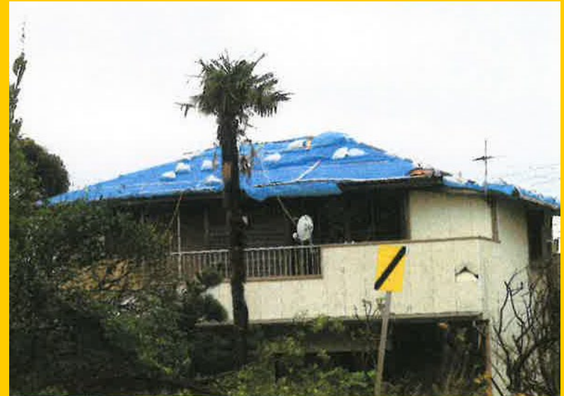
民家の屋根瓦破損
