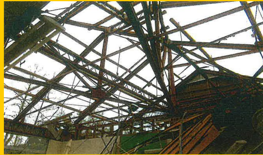
旧下佐久間小学校 普通教室屋根・外壁破損
