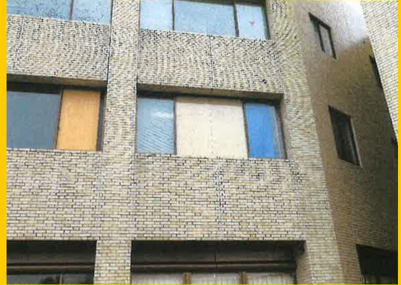
鋸南町役場の窓ガラスが多く破損（一部は修繕済み）
