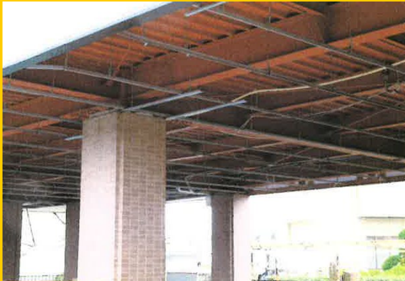
鋸南町役場脇の建物、1階天井崩落
