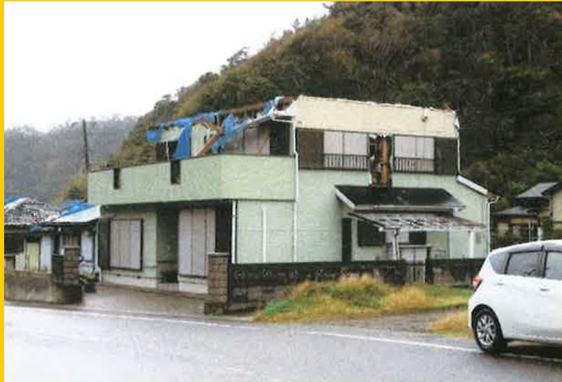
民家の屋根が吹き飛んでいる
